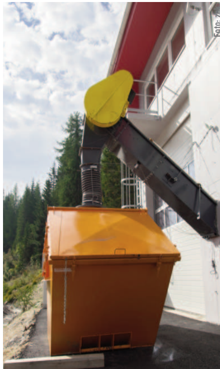
Der Aschecontainer befindet sich im Außenbereich der Heizanlage.
